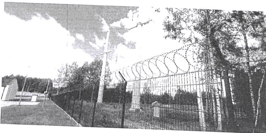
Otoczenie stacji elektroenergetycznej 110/15 kV Żelechlinek
