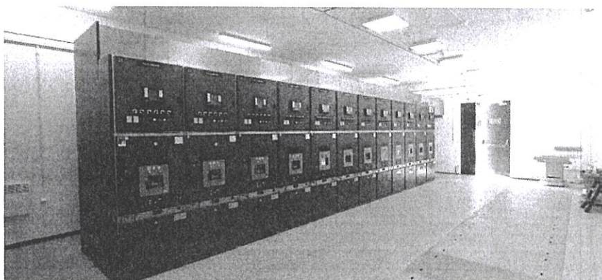
Rozdzielnia wewnętrzna 15 kV
