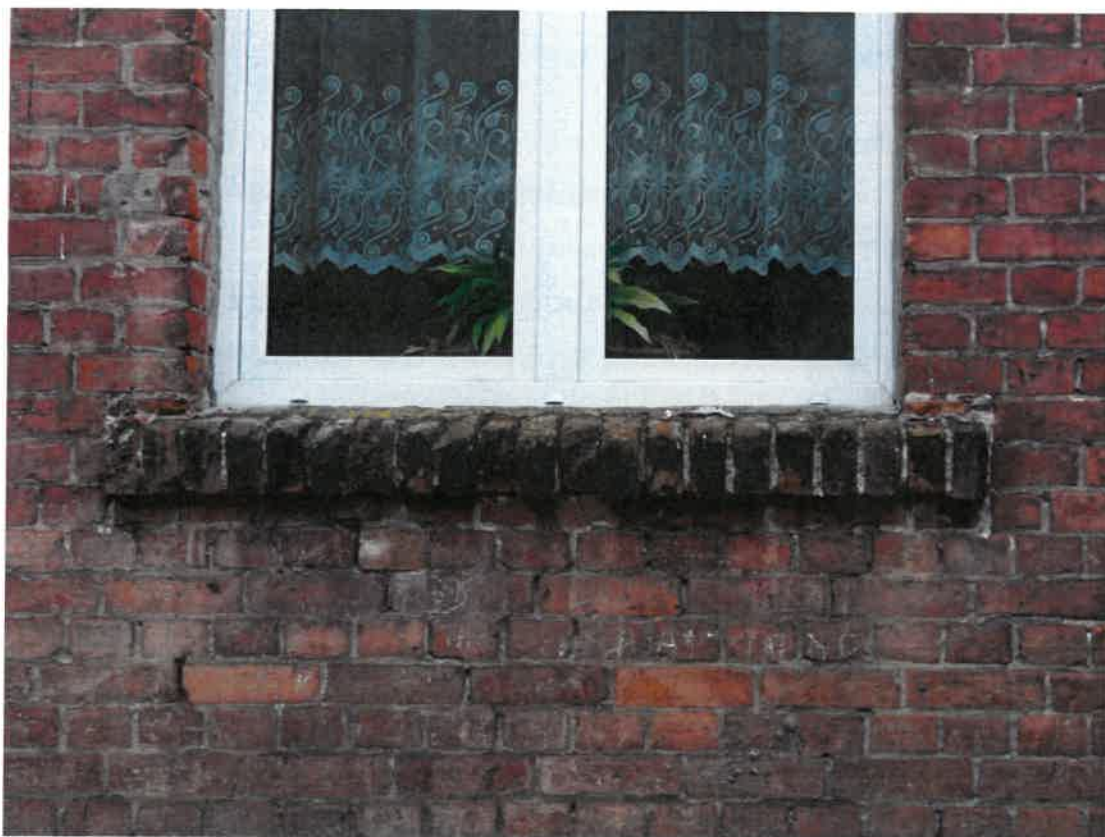
Elewacja zachodnia, parter – ubytki muru w obrębie okna.
