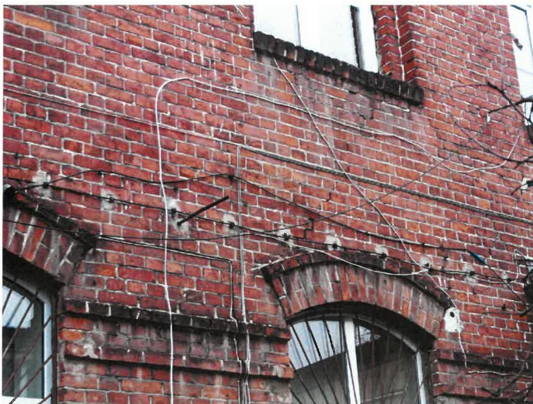
Spękanie muru w obrębie elewacji południowej.
