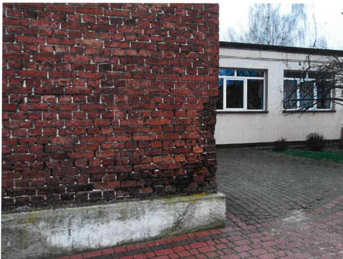
Uszkodzenie narożnika południowo-zachodniego.
