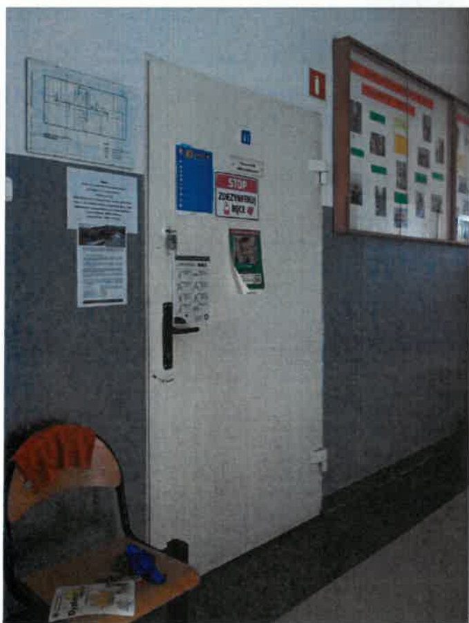
Drzwi przewidziane do wymiany.
